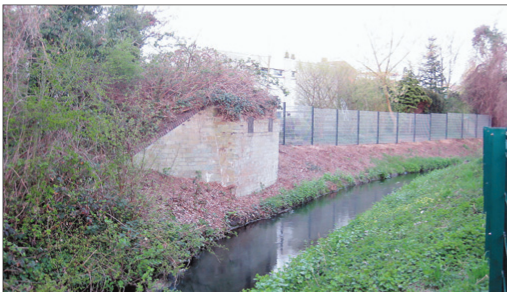
Eines der letzten Teile der alten Ruhr-Lippe Kleinbahn im Stadtgebiet von Soest ist das nördliche Brückenwiderlager. Jetzt ist es wieder zu sehen. ■ Foto: Burkert
